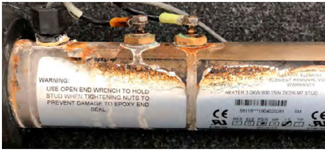
Eroderet varmelegeme med tærede pakninger.
